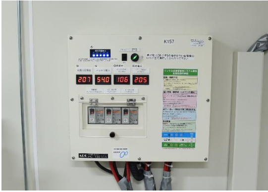
【蓄電池システム配電盤】
